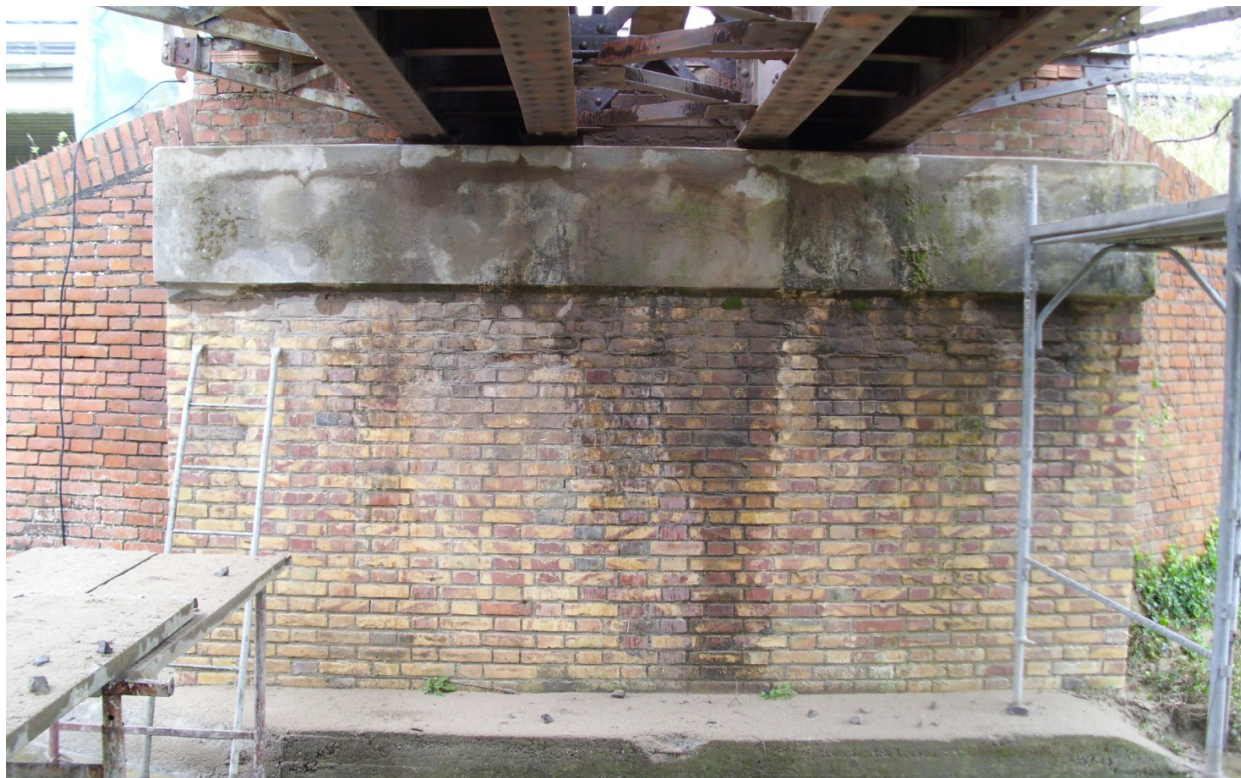
Figura 7 – Vista dell'umidità sulla spalla lato Cecina
